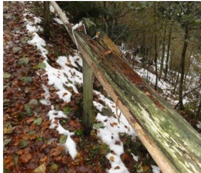
Cette balustrade pourrie ne remplit plus sa fonction.
