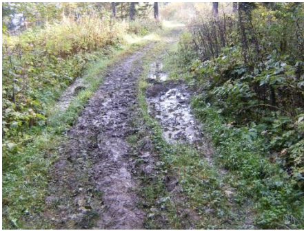
Exemple de chemin forestier mal drainé.
