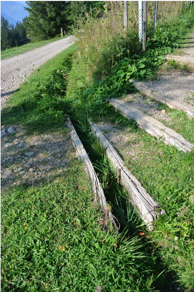
Abb. 4-19: Funktionsfähiger Querabschlag unterhalb Rigi Scheidegg (Foto: R. Corrodi)
