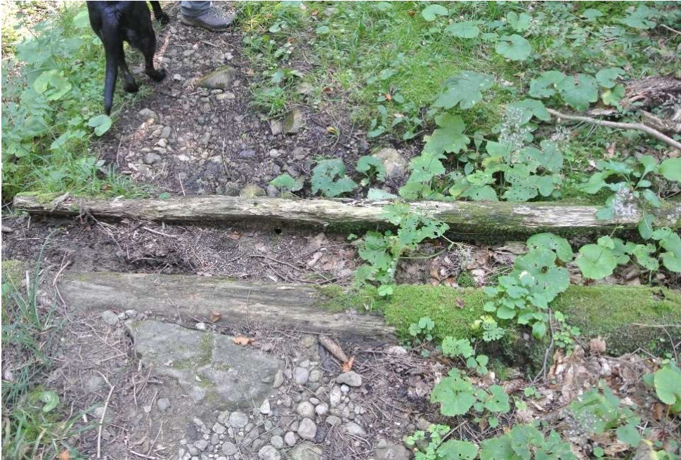
Abb. 4-20: Sanierungsbedürftiger Querabschlag oberhalb Ochsenchneu. (Foto: R. Corrodi)
