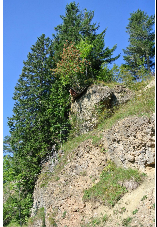
Abb. 4-10: Bäume an der Oberkante der Felswand, deren Wurzeln den Untergrund destabilisieren (Foto: R. Corrodi)
