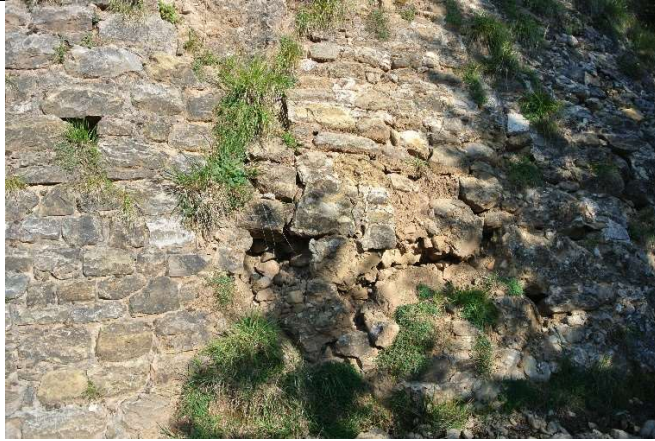
Abb. 4-9: Marode Blocksteinmauer an der Felswand «Elend» (Foto: R. Corrodi)
