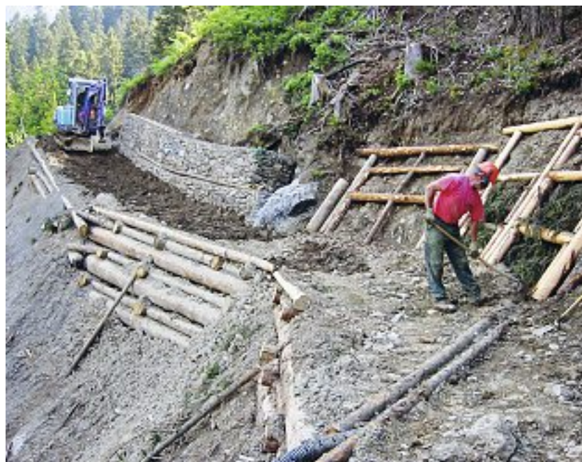
Fig. 81 Consolidamento di una scarpata mediante palificate di sostegno (a sinistra), gabbioni (sullo sfondo) e grata di sostegno (a destra)
