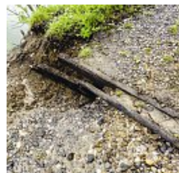
Fig. 95 Scarsa manutenzione di una canaletta di scolo trasversale
