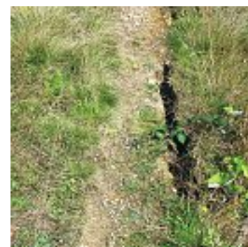
Fig. 5 Crepa nel terreno
