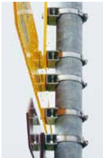
Fig. 23 Tutte le fascette sono serrate sullo stesso lato del palo
